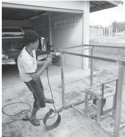
ภาพที่ 7 ตกแต่งโครงสร้างเครื่องสูบน้ำอัจฉริยะพลังงานแสงอาทิตย์
